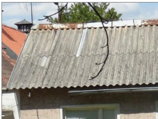
Fot. 1 Płyty azbestowo-cementowe faliste
