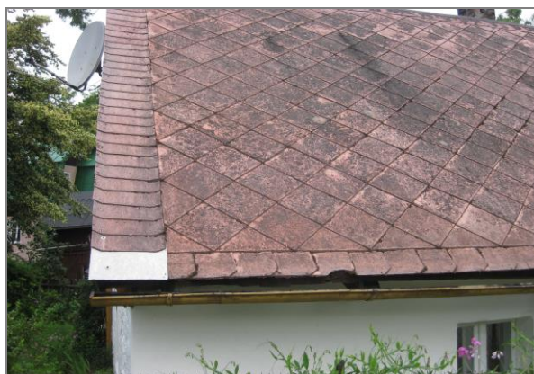
Fot. 2 Płyty azbestowo-cementowe płaskie
